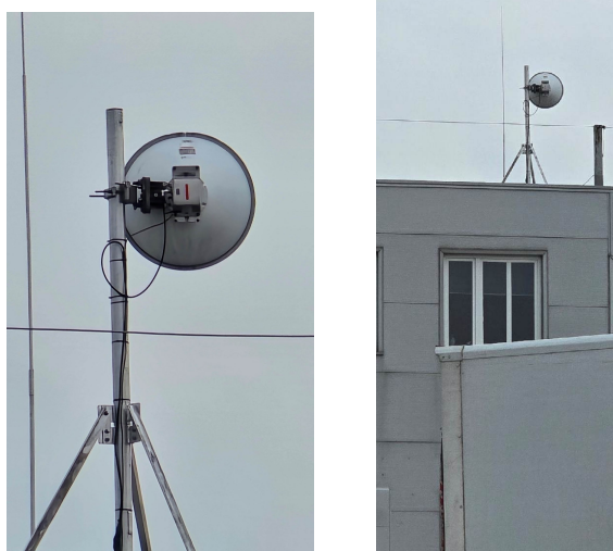
Widok obiektu wraz z zainstalowanym zespołem antenowym
